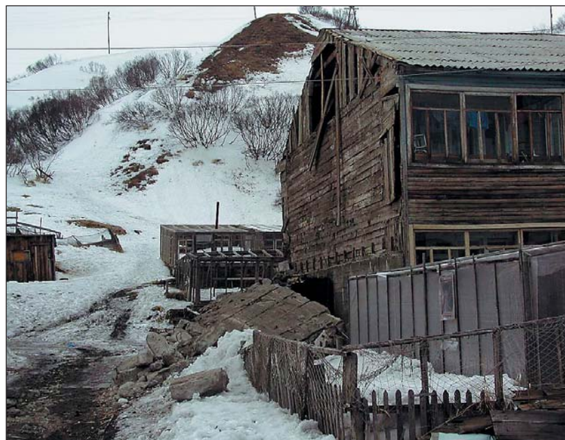
Разрушенная бетонная «рубашка», укреплявшая стену деревянного дома в с.Тиличиха.
